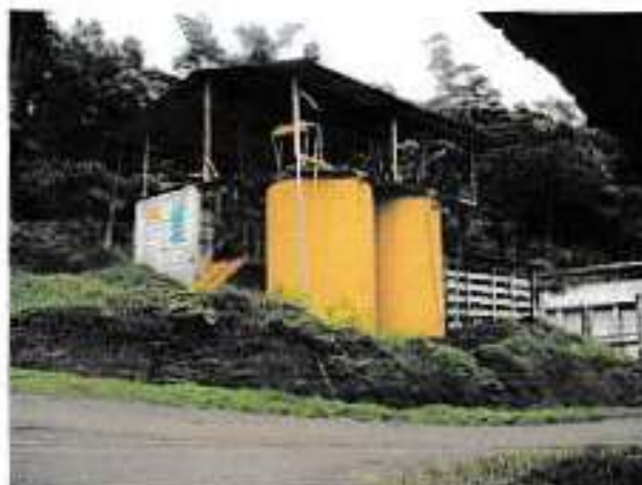
Tanques de tratamiento de excedentes de agua
