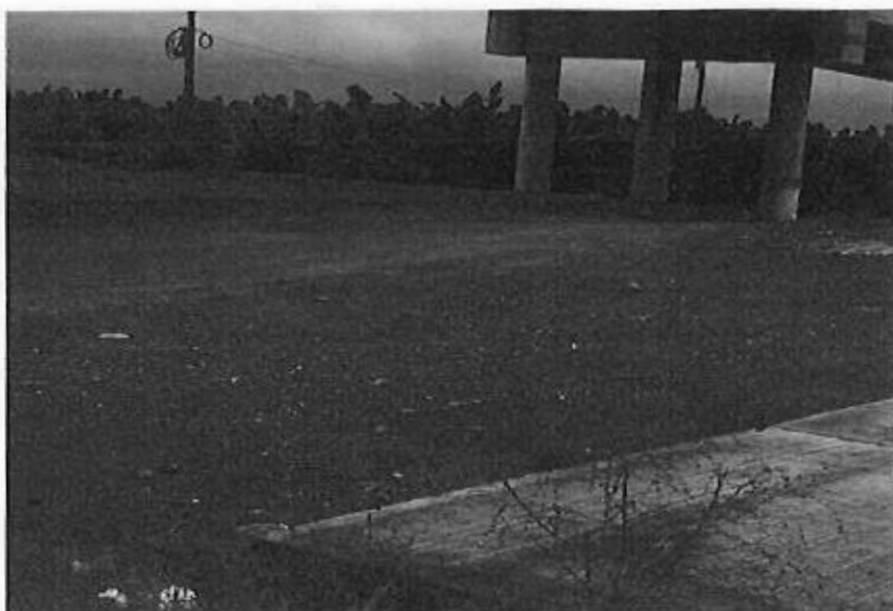
Estado actual sector inferior del puente Unión Colombiana.
