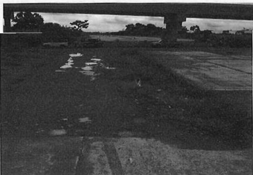
Estructura de pavimento hidráulico faltante en sector de la Unión colombiana.
