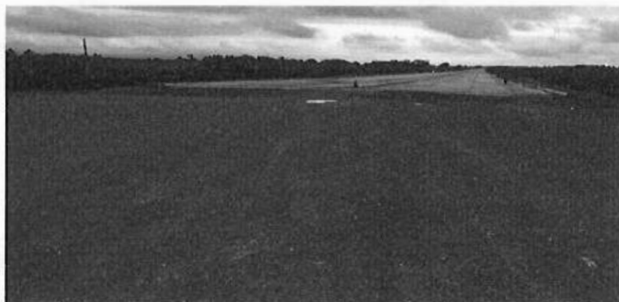
Estado actual del tramo abscisa 27+600
